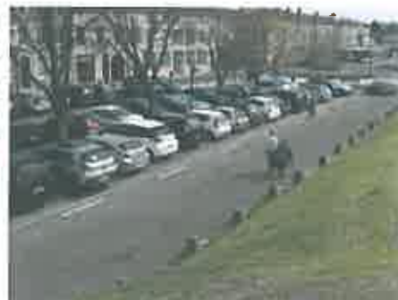
Revêtement dégradé Absence d'indication sur le fonctionnement de la circulation du parking (provoque des contresens)
